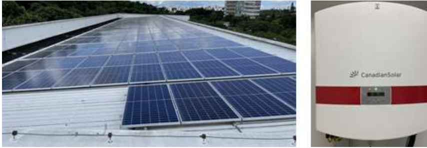
Figura 1 - Arranjo contendo Módulos Fotovoltaicos modelo CS3W-415P e Inversor Trifásico modelo CSI-30KTL-GI-L
