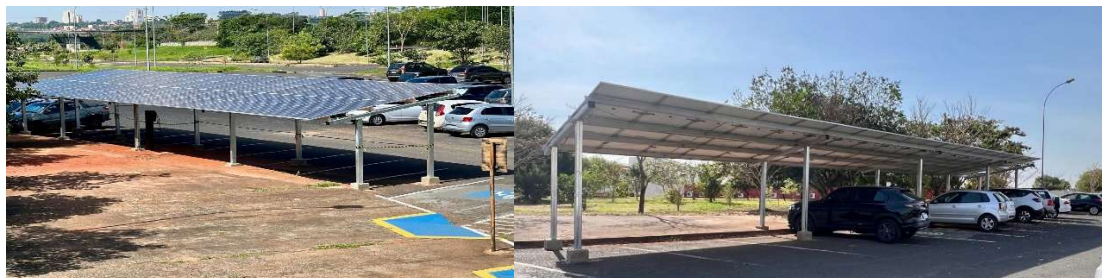
Figura 2 – Estação de carregamento de veículos
