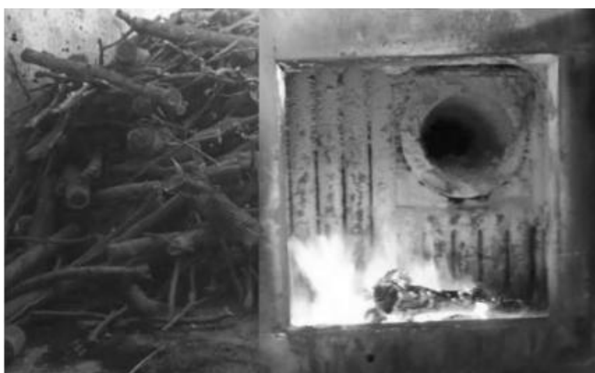
Figura 1. Detalhe da lenha nativa armazenada e da fornalha de uma lavanderia em Caruaru . Fonte: os autores.
